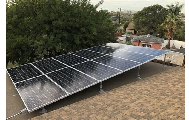
Paneles solares en azotea
