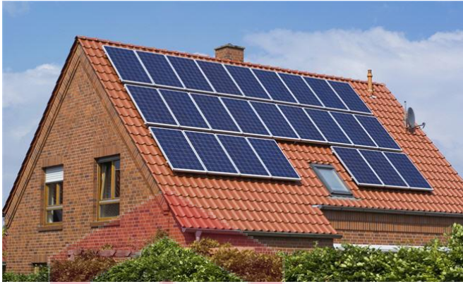
Paneles solares en techo a dos aguas
